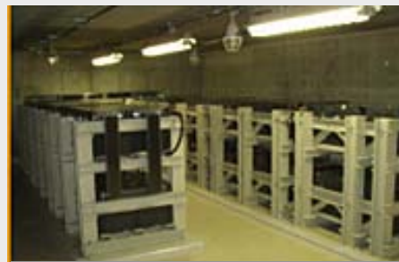
蓄電池増強・分散配置
