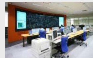
システム制御室
