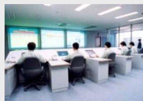
遠隔監視センター
